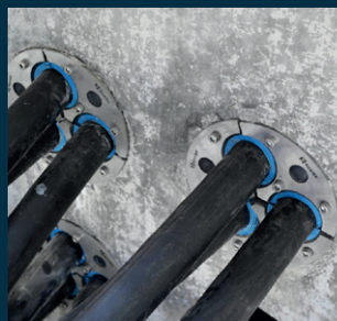
HV power cables
